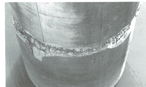
図-11 損傷状況写真③
