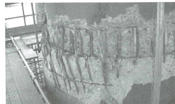
図-10 損傷状況写真②
